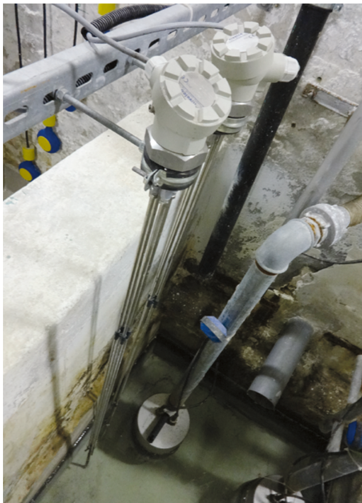
Konduktív szintkapcsolók szondái szabadtéri vízgyűjtőben
