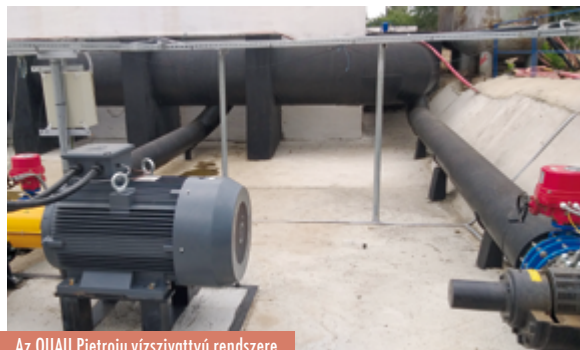
Az OUA I Pietroui vízszivattyú rendszere
